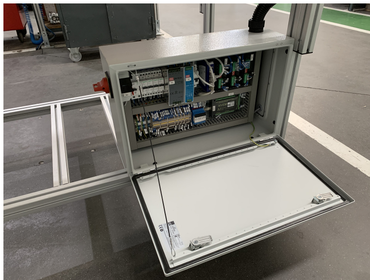
(b) Quadro elétrico (porta aberta).
