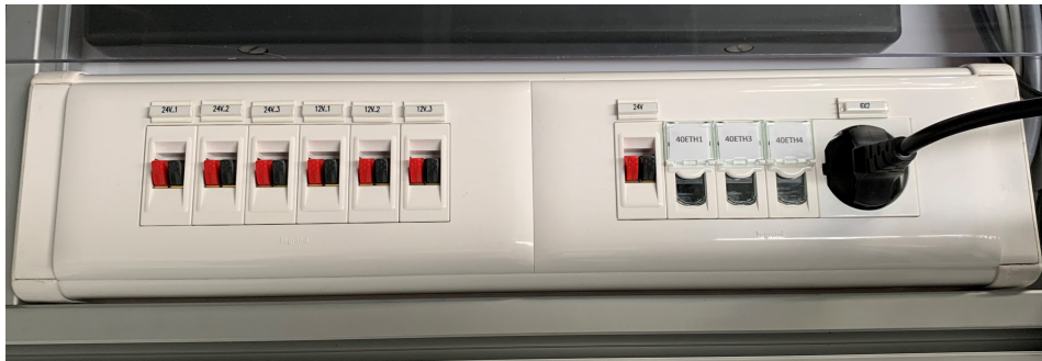
Figura 5.6: Calha personalizável de saídas elétricas.
