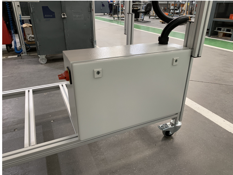
(a) Quadro elétrico (porta fechada).
