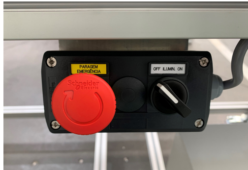
Figura 5.7: Botão de emergência e comutador de iluminação.
