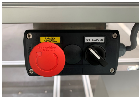
(b) Caixa de botões (Emergência e comutador).
