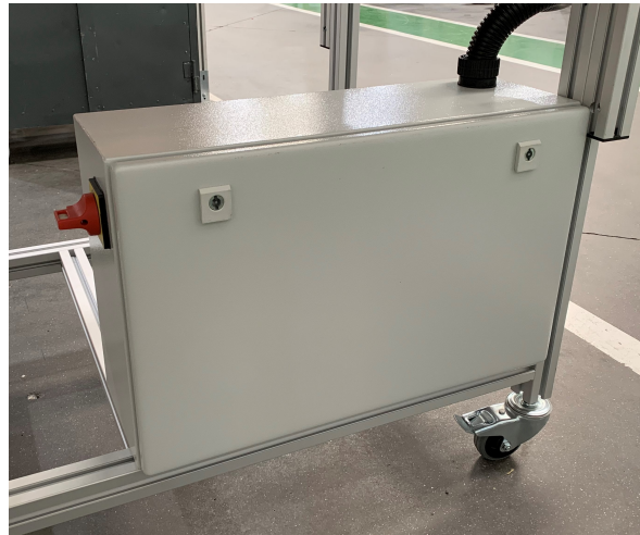
Figura 5.4: Quadro elétrico (porta fechada).
