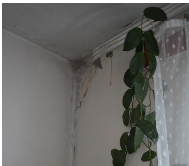
Obr. 98: Rohové poškození konstrukce - fotografie
