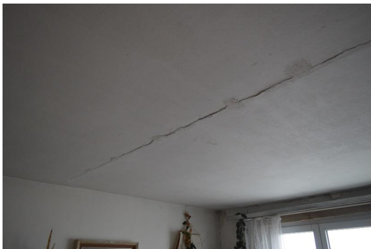
Obr. 96: Vznik trhlin na stropních panelech - fotografie
