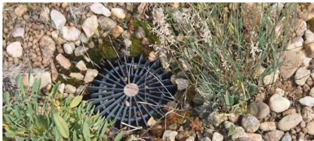
Obr. 11: ŠPATNĚ provedená střešní vpust' ve vegetační střeše
