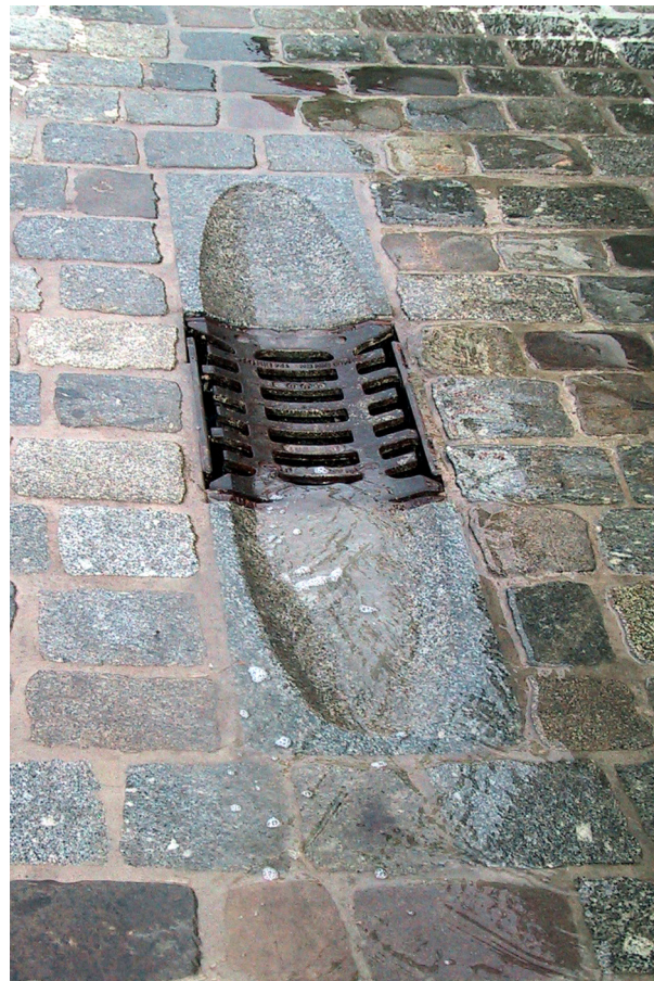
Platsunik avvattning i Bremerhaven Old and New Harbour, Tyskland. Ett nyligen restaurerat industri- och hamnområde där detaljerna utformats i linje med hela projektets anda.
