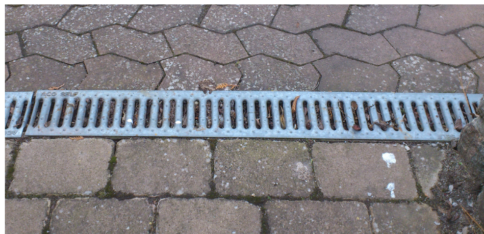
Linjeavvattningsgaller av mycket vanlig sort. Både färg och linjespel avviker från omgivande material.
