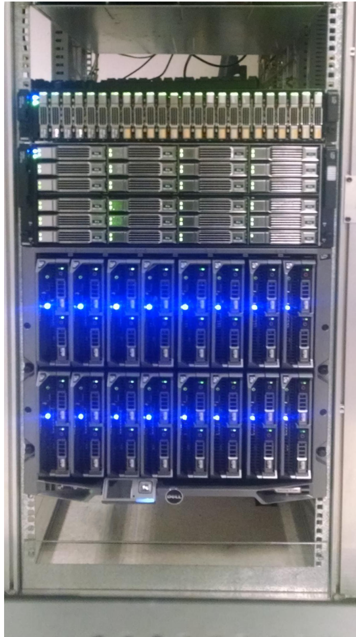
Figura 3: il sistema di calcolo Blade e lo storage Equallogic
