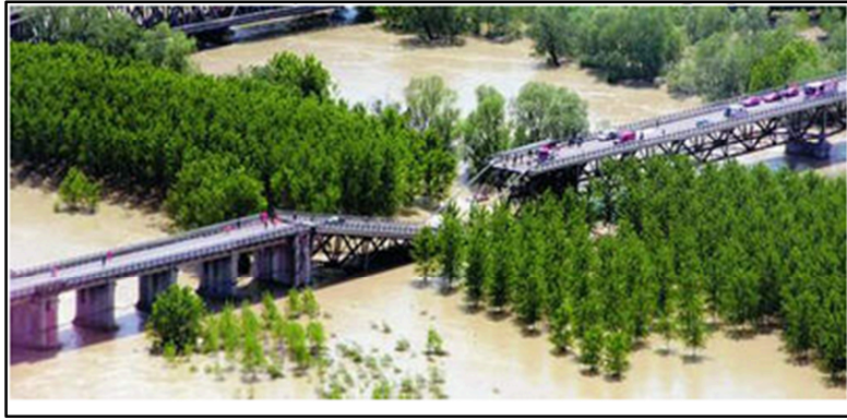
Fig.1.2 Crollo di un viadotto presso San Rocco al Porto (Lodi) nel marzo 2009; la continua erosione dovuta all'eccesso di velocità della corrente nei pressi delle pile del ponte ha causato cedimenti nelle fondazioni. In questa raffigurazione si evidenzia l'importanza che ricopre la vegetazione nella corretta gestione dell'alveo anche in chiave strutturale
