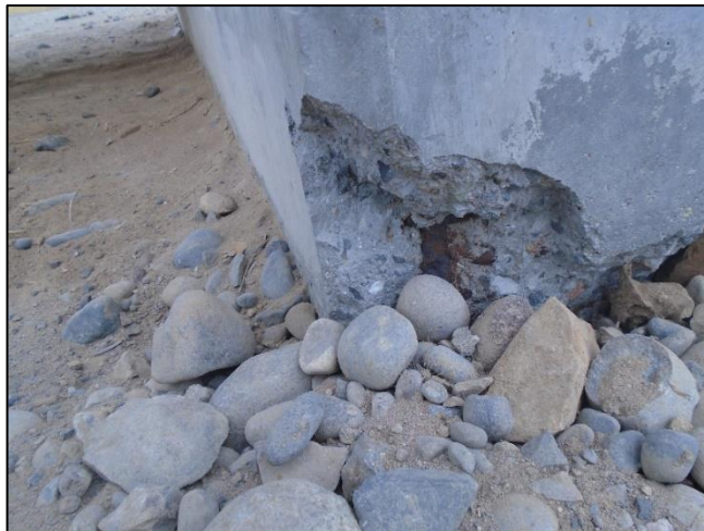
Figura 13: Erosión química en pedestal. Fuente: Elaboración propia.
