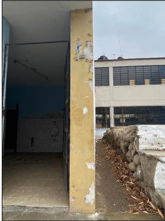
Figura 17: Manchas en columna. Fuente: Elaboración propia.
