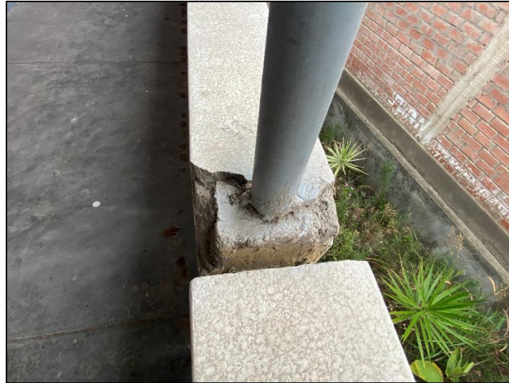
Figura 9: Desprendimiento de material en parapeto. Fuente: Elaboración propia.
