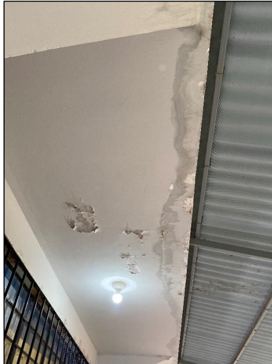
Figura 20: Humedad en losa aligerada de alero. Fuente: Elaboración propia.
