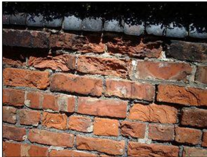
Figura 4: Erosión en mampostería de ladrillo artesanal. Fuente: Búsqueda de google.
