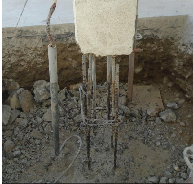
Figura 12: Oxido y corrosión en pedestal. Fuente: Elaboración propia.
