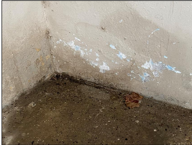
Figura 3: Humedad en parte inferior de muro Fuente: Elaboración propia.
