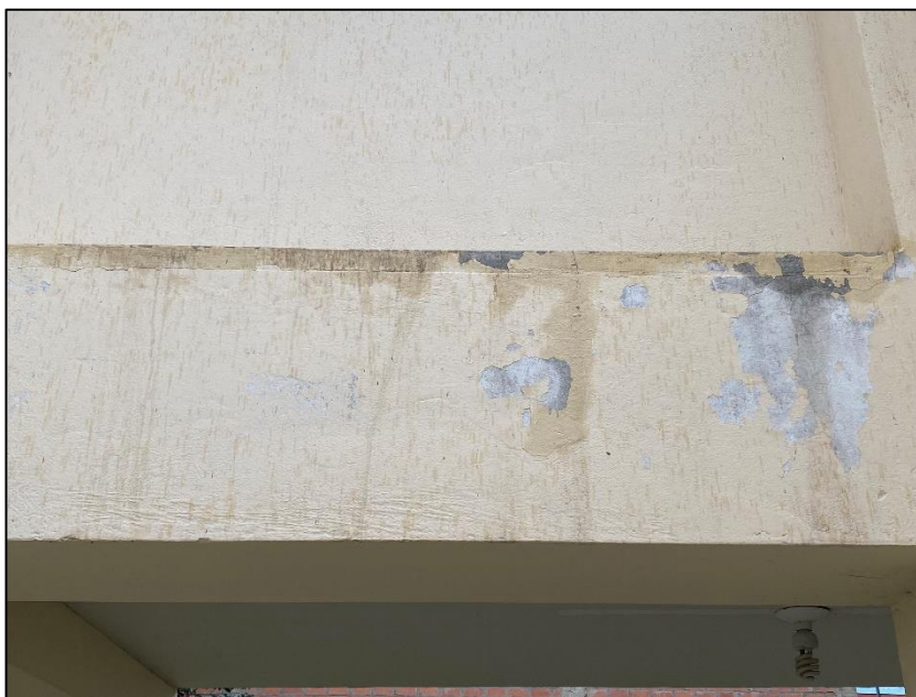
Figura 16: Humedad y eflorescencia. Fuente: Elaboración propia.
