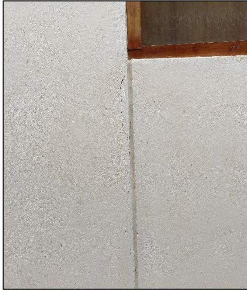
Figura 18: Fisura en junta de dilatación. Fuente: Elaboración propia.
