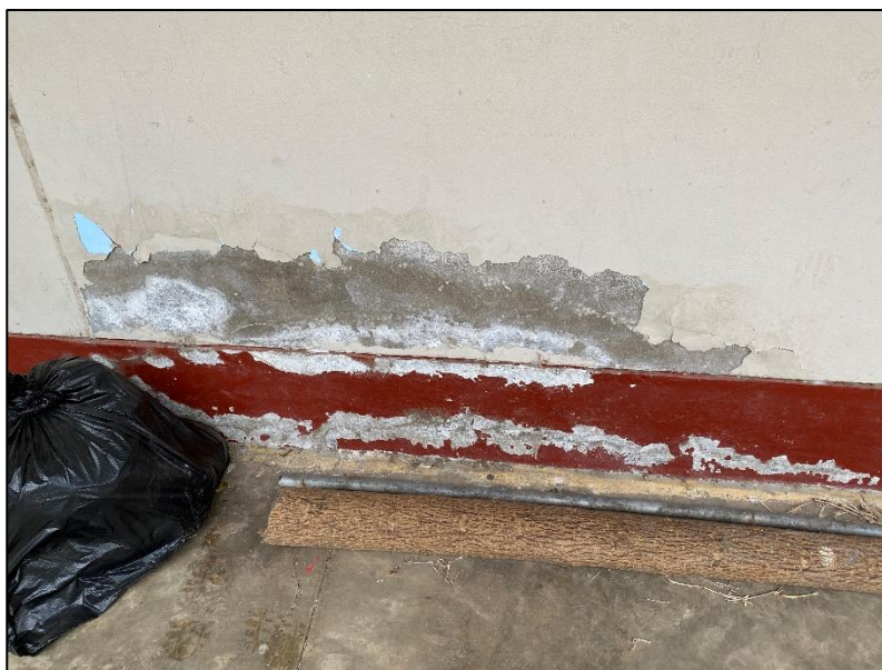
Figura 11: Eflorescencia en parte inferior de muro. Fuente: Elaboración propia.
