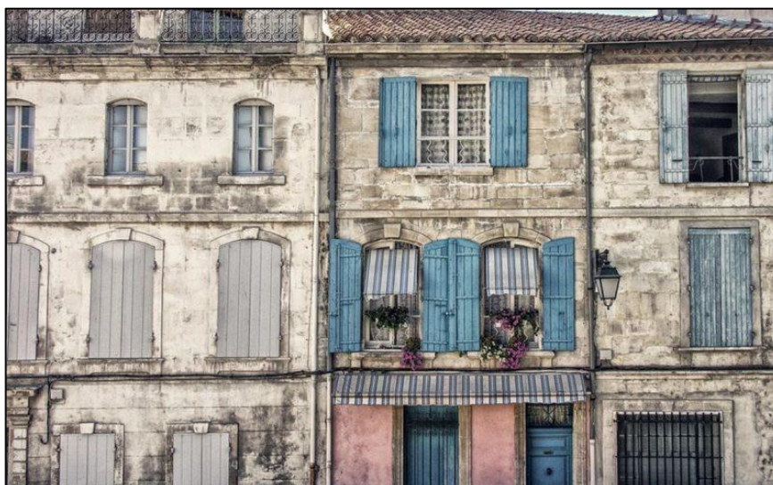
Figura 5: Suciedades en fachadas de viviendas. Fuente: Búsqueda de google.
