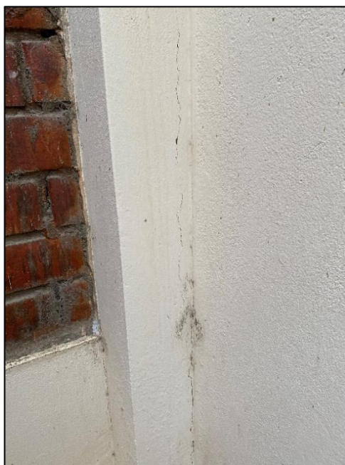
Figura 8: Fisura en columna.
