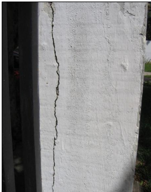
Figura 7: Grieta en columna. Fuente: Búsqueda de google.
