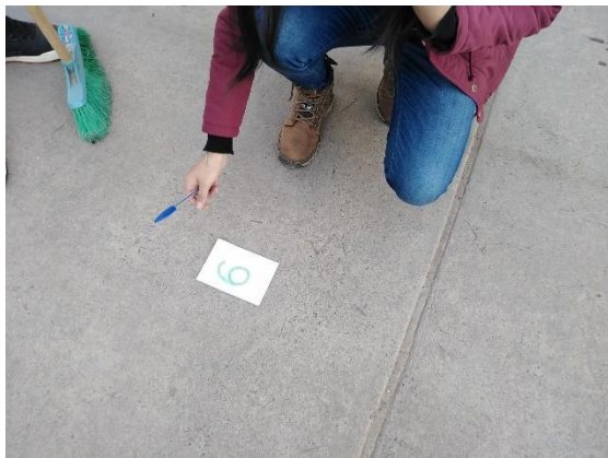
Se aprecia falla pulimiento de agregados en la losa n°6
