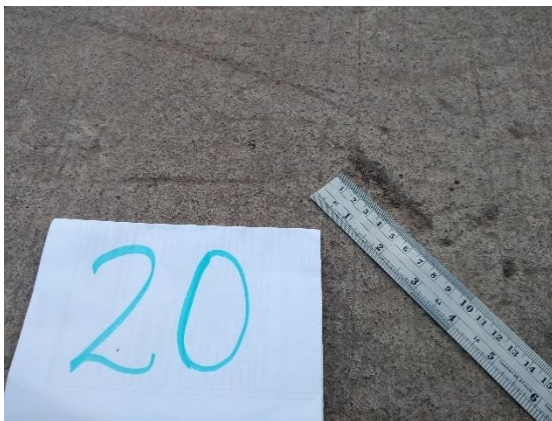
Se aprecia falla popouts en la losa n°20
