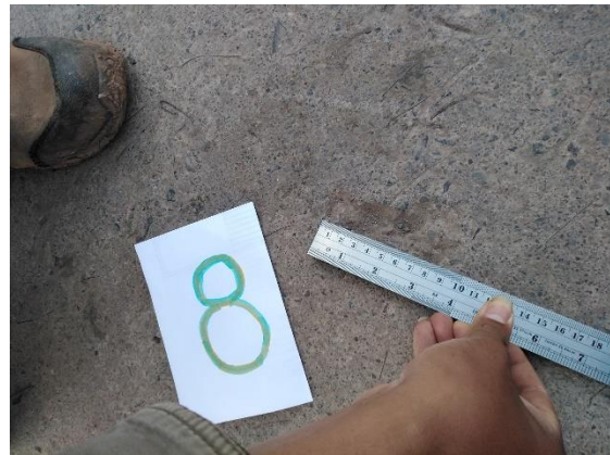
Se aprecia falla popout en la losa n°8
