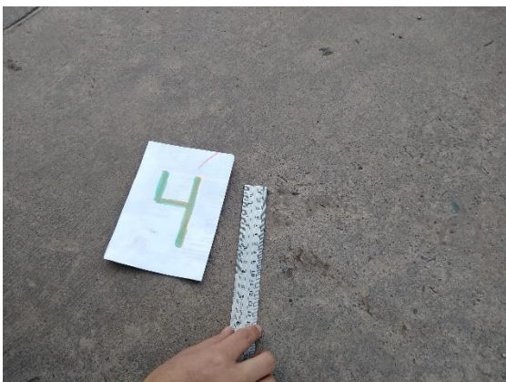
Se aprecia falla popout en la losa n°4
