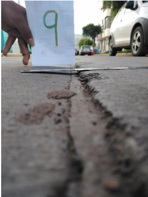
Se aprecia falla desnivel de carril en la losa n°9
