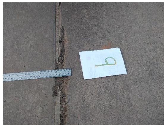
Se aprecia falla de junta en la losa n°9
