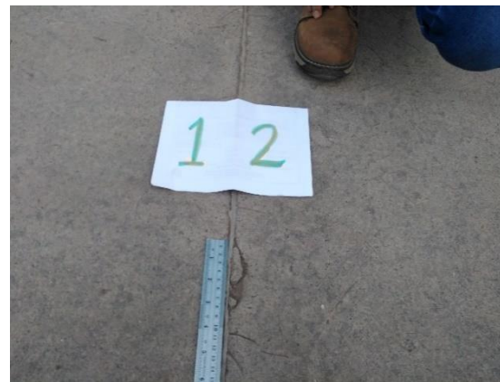
Se aprecia falla de junta entre la losa 1 y 2
