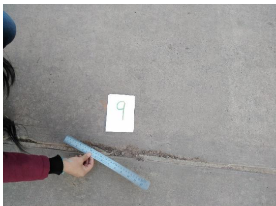
Se aprecia falla de junta en la losa n°9
