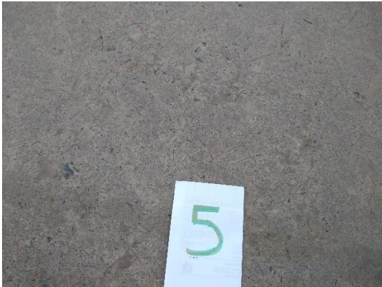
Se aprecia falla pulimiento de agregados en la losa n°5
