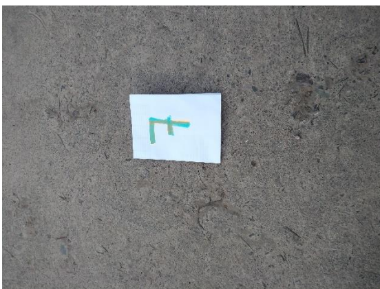
Se aprecia falla pulimiento de agregados en la losa n°7
