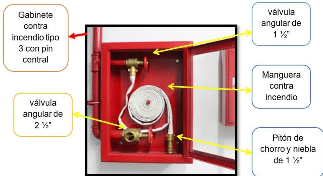
Figura N°01 Gabinete contra incendio y sus componentes
