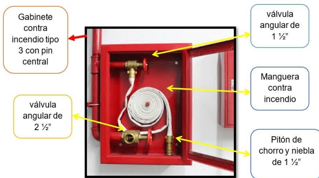
Figura N°12 Gabinete contra incendio y su equipamiento
