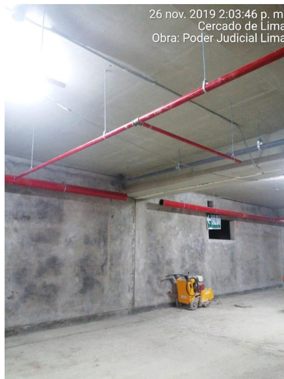
Figura N°08 Soportes de tuberías con varillas roscadas y colgadores tipo gota
