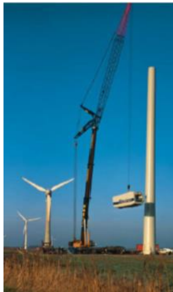
Figura 19: Torres tubulares cónicas e instalaciones de aerogeneradores de gran potencia
