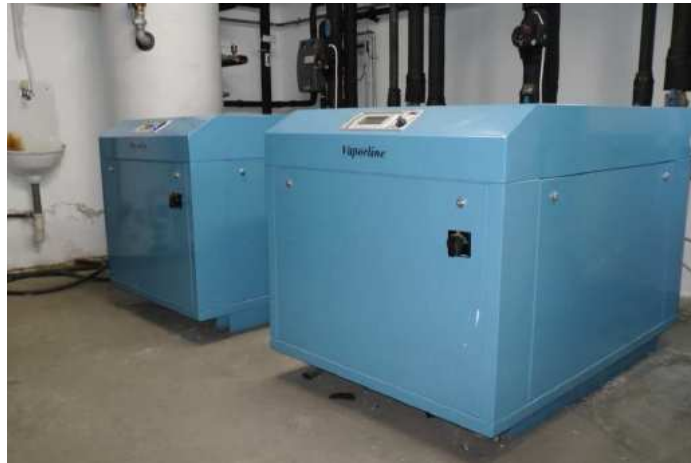
10. ábra. A Vastalanító épület (Zalavíz Zrt.) hőközpontja a magyar fejlesztésű és gyártású növelt hőmérsékletű hőszivattyúkkal
