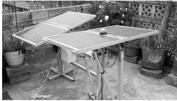
Figura 3. Sistema de medición montado sobre una estructura soporte de aluminio.
