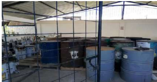
Figura 18-3. Almacenamiento de aceite dieléctrico
