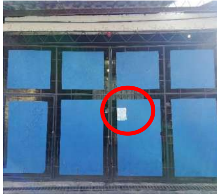
Figura 9-3. Señalética de ingreso a bodega en malas condiciones Realizado por: Cherres, N.; Salán, J. 2019
