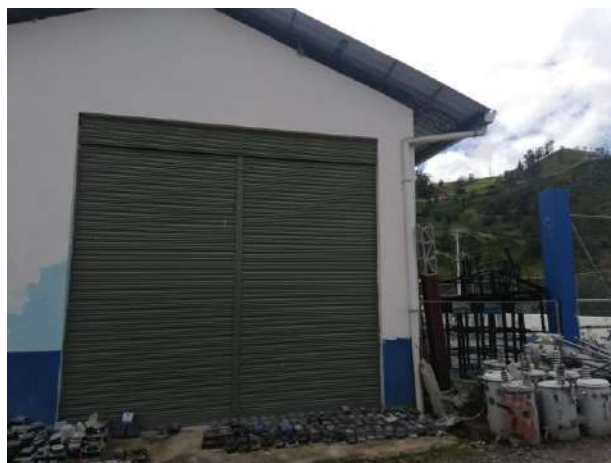
Figura 13-3. Inexistencia de señalética en la subestación Realizado por: Cherres, N.; Salán, J. 2019
