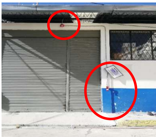
Figura 11-3. Sistema contra incendio en malas condiciones Realizado por: Cherres, N.; Salán, J. 2019
