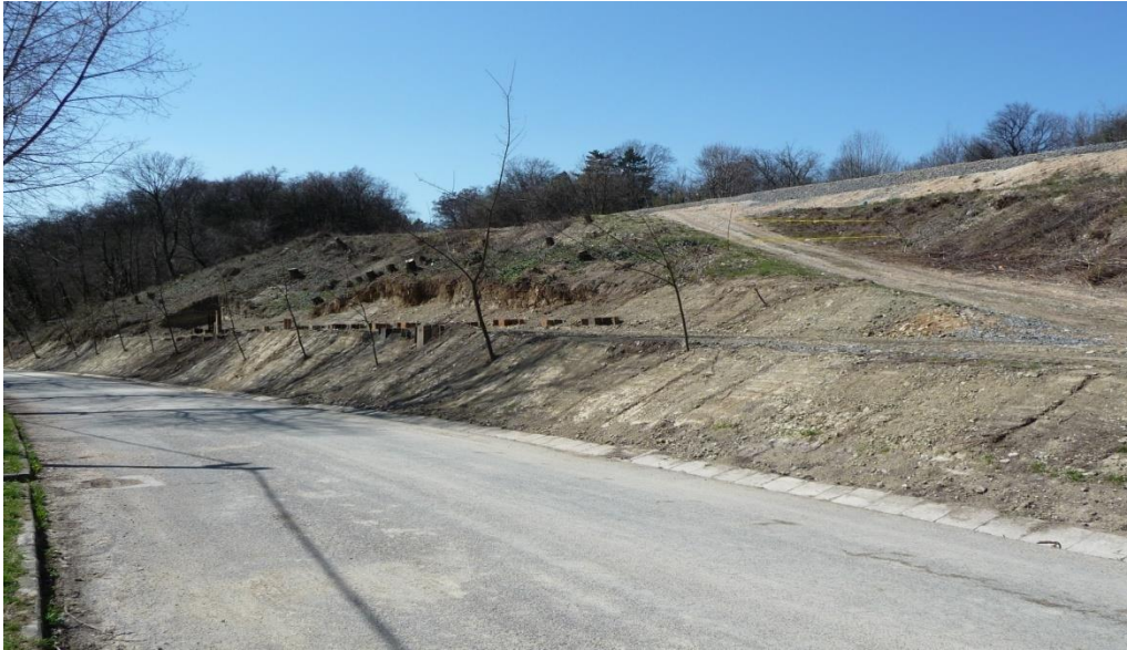
4. kép: Balatonakarattya vasúti töltés részsű csuszása 2010
