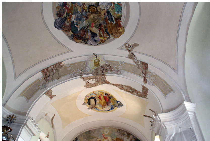
17. ábra A tehergépjármű-forgalom miatti rezgések okozzák a nagylózsi római katolikus templomban a boltozatok egyre táguló repedéseit
