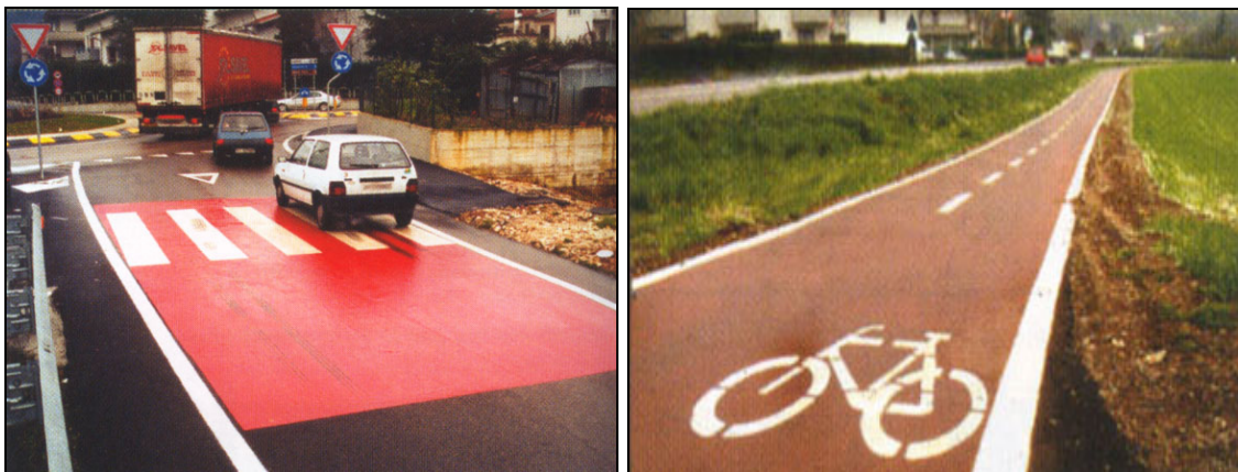
Fig. 6.5 – Colorazione del manto stradale in corrispondenza di piste ciclabili
