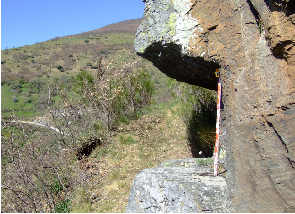
Figura n.º 9: Sección en semitúnel del canal C-3 en las inmediaciones del santuario de la Virgen del Valle (Llamas de Cabrera). Foto: R. Matías.
