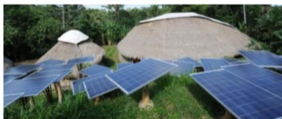
Gambar 5. Solar Panel yang dimiliki oleh Green School Bali
