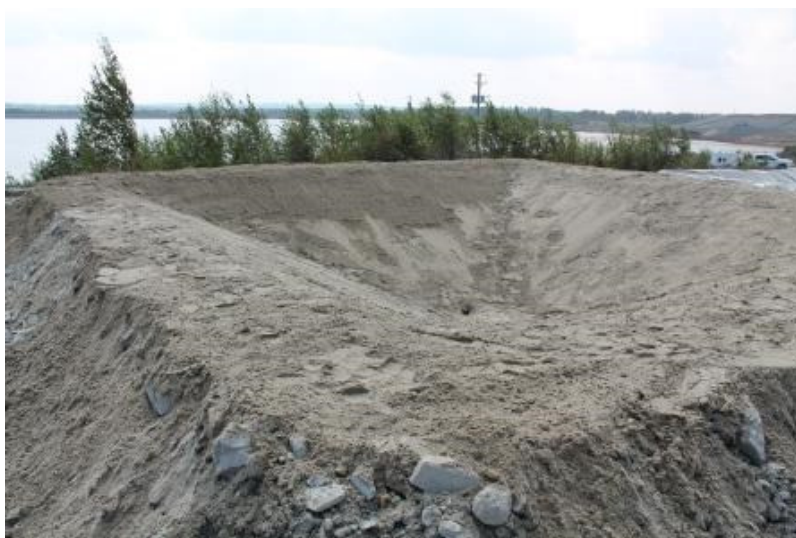
Figure 3-33 : Mise en place de la couche de sable dans la cellule CR-4
