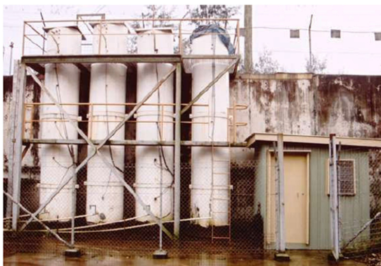
Figure 2-2 : Méso-colonnes à la mine Porgera (Wickland, 2006)
