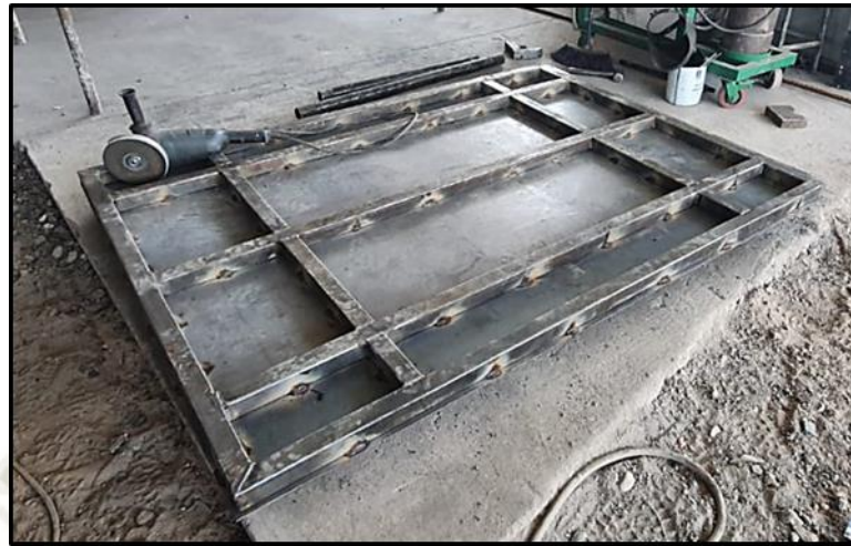
Figura 95 Armado Estructura para Plataforma Deslizante Interior en la Autoclave. Fuente: Elaboración Propia
