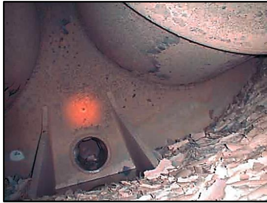
Figura 16 Acumulación de Incrustaciones en Calderas de Vapor. Fuente: FENERCOM (2020)
