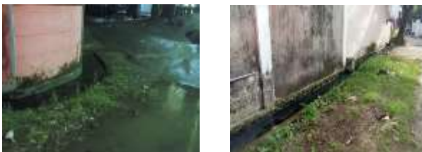
Gambar 2. Kondisi Drainase yang tergenang Mitra 2
