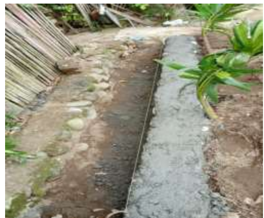
Gambar 7. Saluran drainase di Perumahan Tamarunang Indah I
