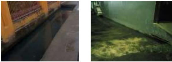
Gambar 1. Kondisi drainase yang tergenang Mitra I
