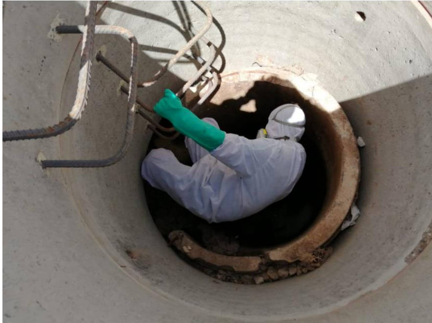
Figura 2-13 Extracción de lixiviados de la red de conducción de Optimización Fase II
