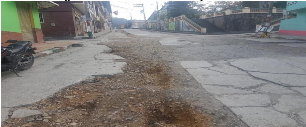
Figura 2 Estado de la vía Cascajal Nocaima
