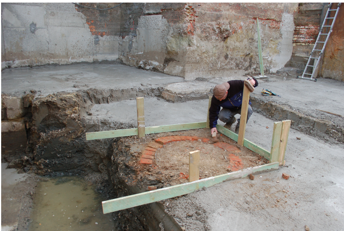
Figuur 3: Het gevrijwaarde deel van de bouwput afgezet met planken (©agentschap Onroerend Erfgoed: Geert Vynckier).
