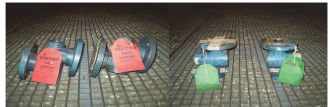
Figura 6. Modelo de etiquetas (Válvulas de aire, lados: A e B). Fuente: Propia.
