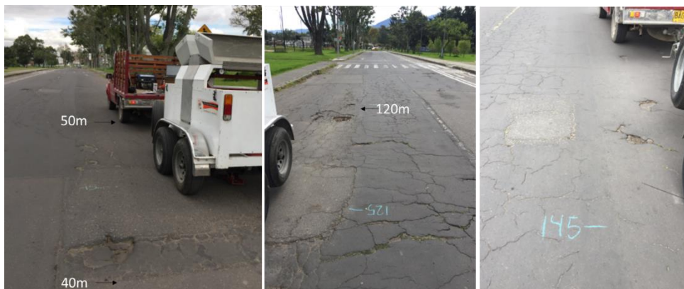
Figura 5-15: Lugares con mayores daños sobre el tramo TRM.
