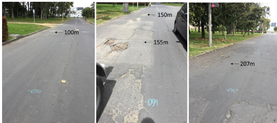
Figura 5-13: Lugares con mayores daños sobre el tramo TRA.
