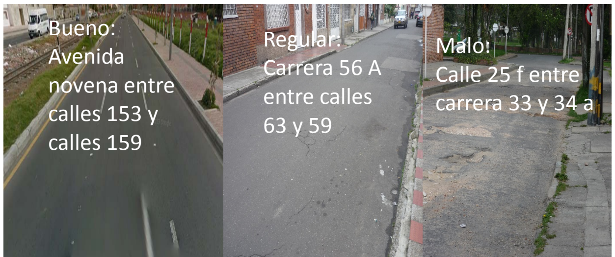
Figura 2-3. Niveles de daño para la clasificación de los tramos evaluados.
