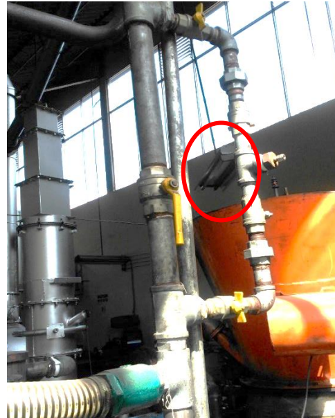
Figura 10. Válvula de paso a la campana
