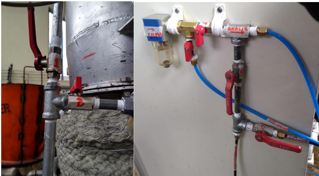
Figura 32. Numeración de válvulas, 1 y 2 en el gasificador, 3,4,5 y 6 en el analizador de gases.
