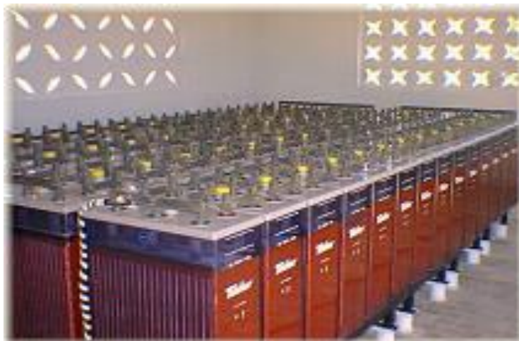
Figura 2-4: Banco de baterías
