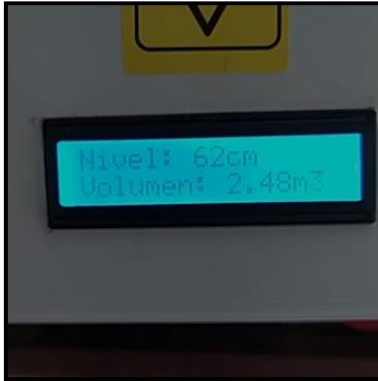
Figura 3-8: Pantalla LCD indicadora de volumen nivel y volumen de agua en tanques de almacenamiento
