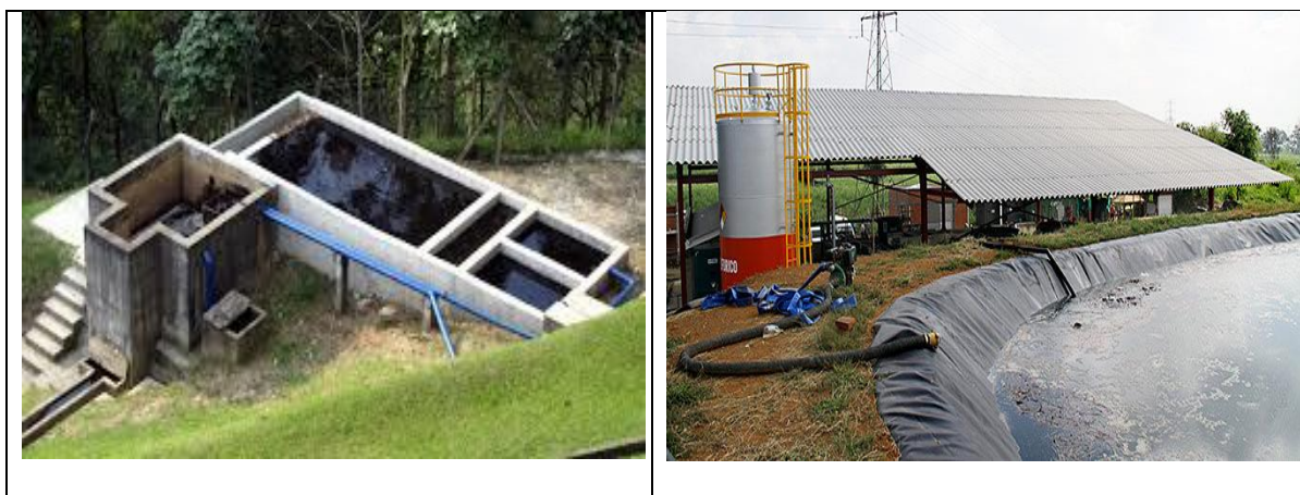
Figura 4-10: Instalaciones para el tratamiento de lixiviados.
