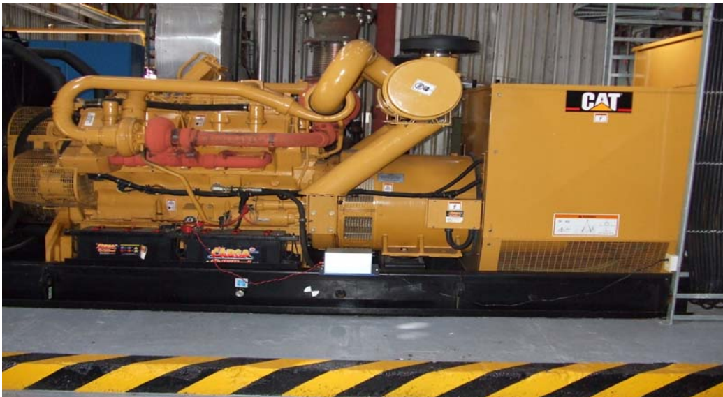
Planta eléctrica Caterpillar
