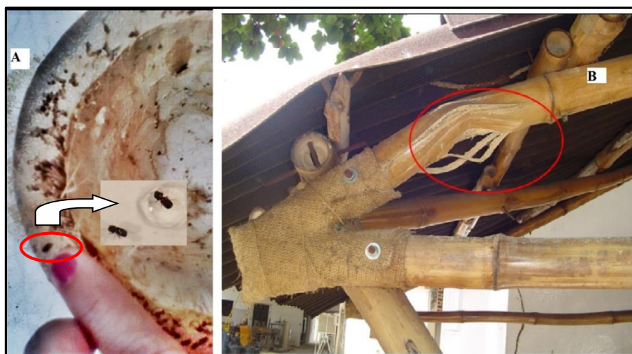
Figura 3-9: Fotografías del ataque causado por insectos sobre un nudo de Guadua angustifolia (A). Deterioro causado por ataque de insectos (B).
