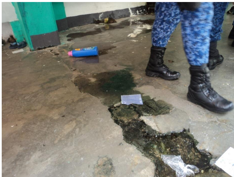
Ilustración 13. EPMSC ERE JP Cúcuta Foto Maria Mauersberger
