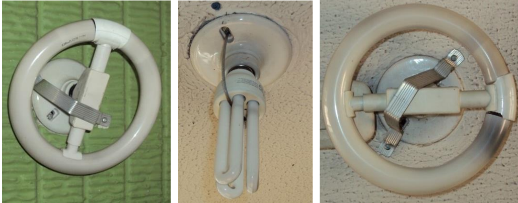
Figura 86. Elementos de seguridad en luminarias de puntos fijos
