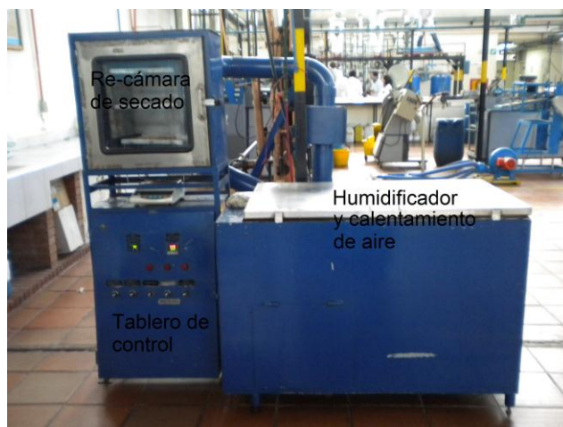
Figura 3.4. Cámara de secado ubicada en la Planta Piloto de Ingeniería Química.
