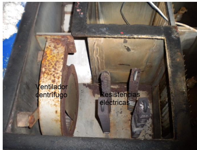
Figura 3.6. Ventilador centrífugo y resistencias eléctricas del secador experimental.
