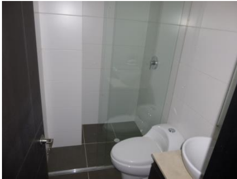
Figura 10-6: Afectación ducha por ductería
