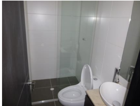
Figura 10-7: Ducha sin afectación
