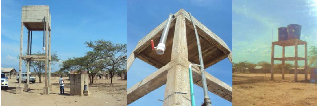
Figura 5. Pozos profundos y sistema para recolección de agua sin terminar e inservibles en sector de El Caimito, municipio de Distracción. Tomado de CDMA. (2014, p. 5).
