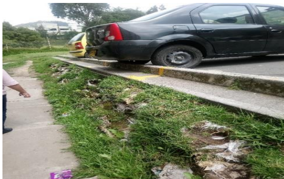
Imagen 47. Relleno para la estabilización del suelo en Colores de Bolonia I Fuente: Elaboración propia. 2019
