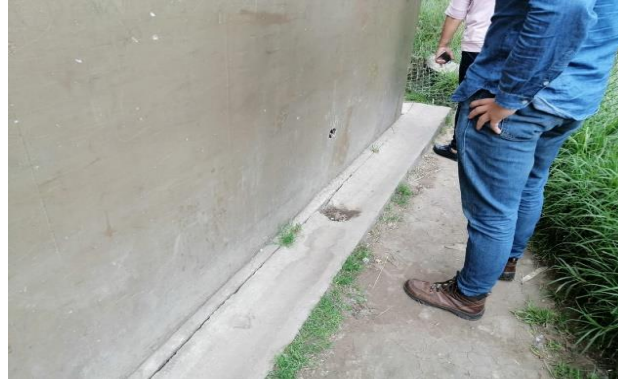
Imagen 43. Agrietamiento de bloques de apartamentos en Colores de Bolonia I Fuente: Elaboración propia. 2019
