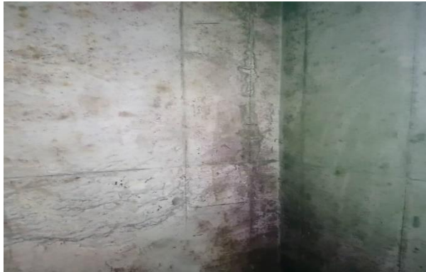
Imagen 42 Presencia de humedad en el primer piso, del bloque 10 en Colores de Bolonia I. Fuente: Elaboración propia. 2019
