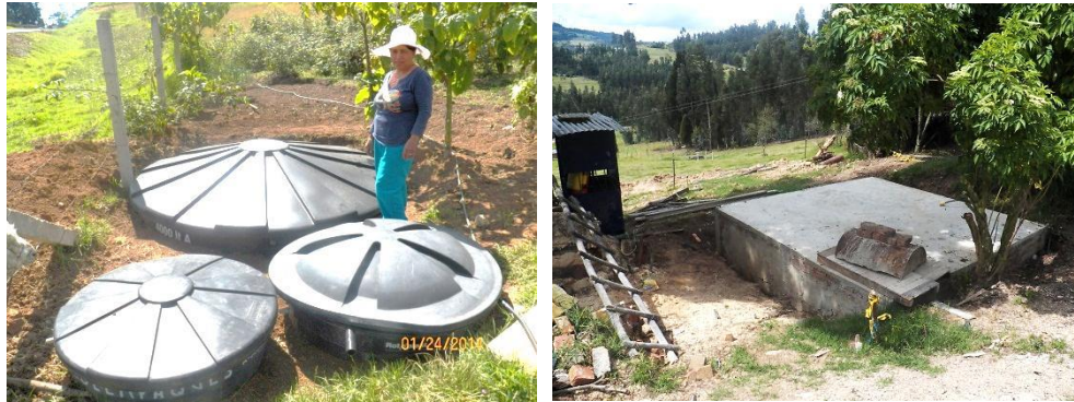
Figura 19: Tanques de 1.000 y 2.000 L para almacenamiento de agua, finca San Antonio, Paipa (izq.); construcción de tanque de concreto enterrado de 18.000 L, finca Casa vieja, Paipa (der.).
