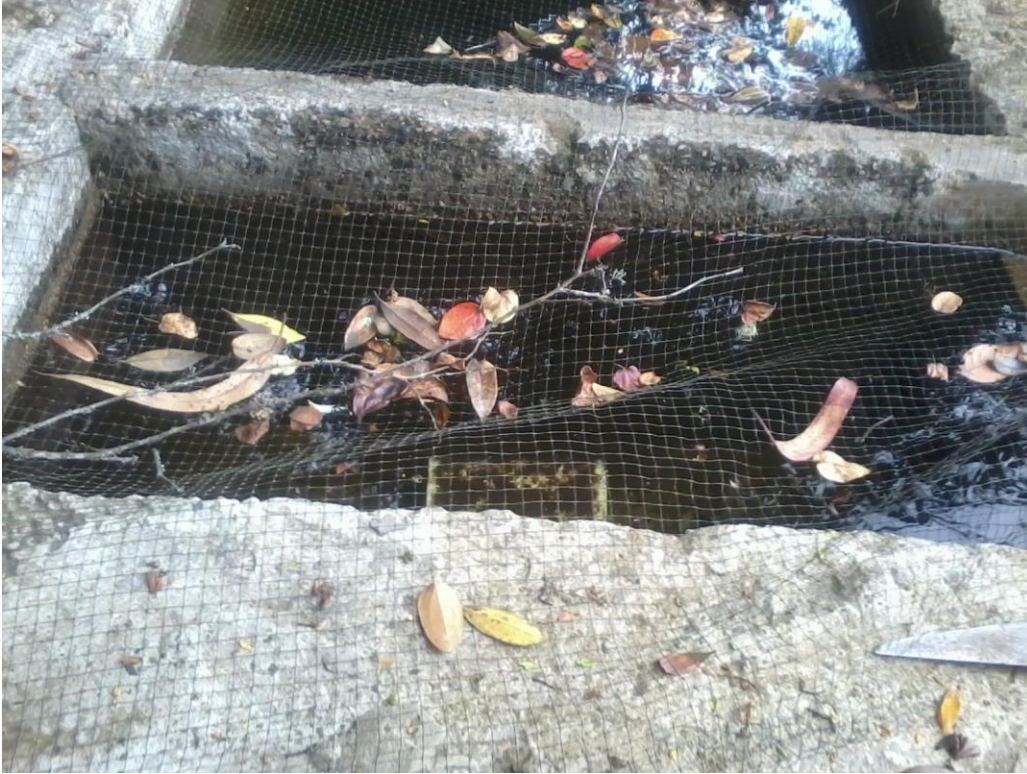
Ilustración 4: Sedimentador Acueducto Los Soches
