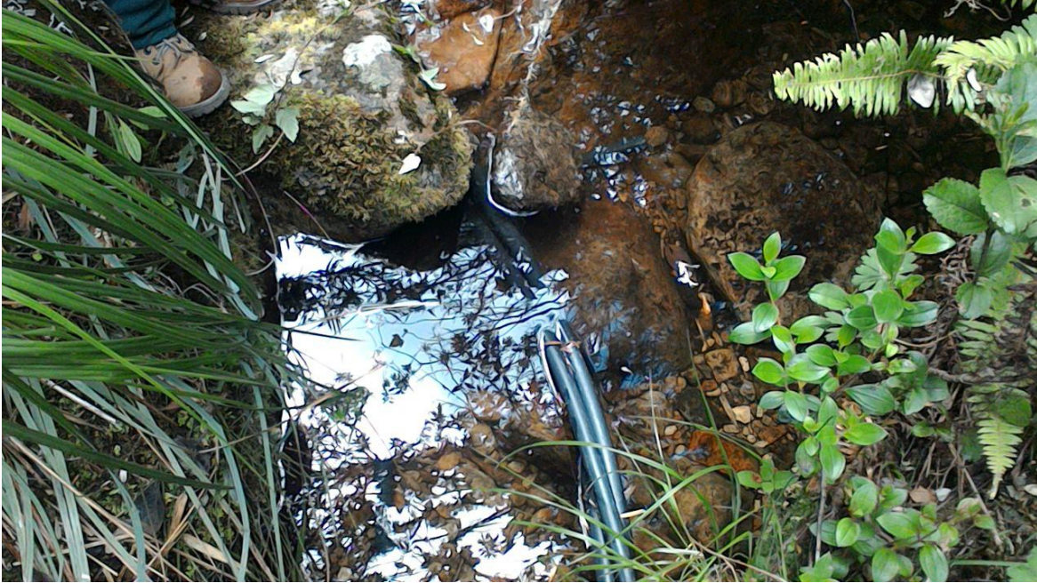
Ilustración 9: Manguera de distribución Acueducto Cerrito Blanco
