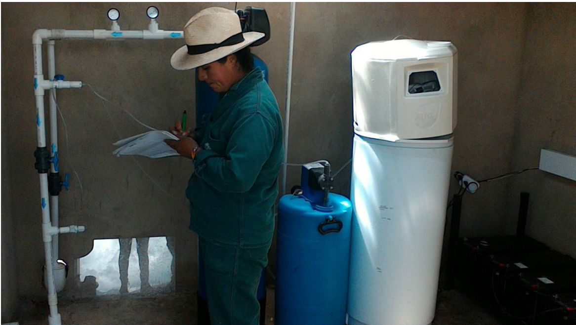
Ilustración 10: Planta de tratamiento
