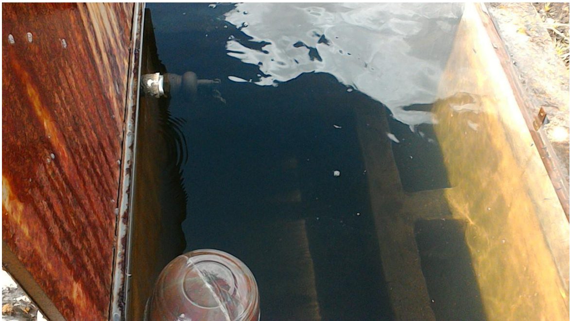
Ilustración 8: Tanque de almacenamiento Acueducto Cerrito Blanco
