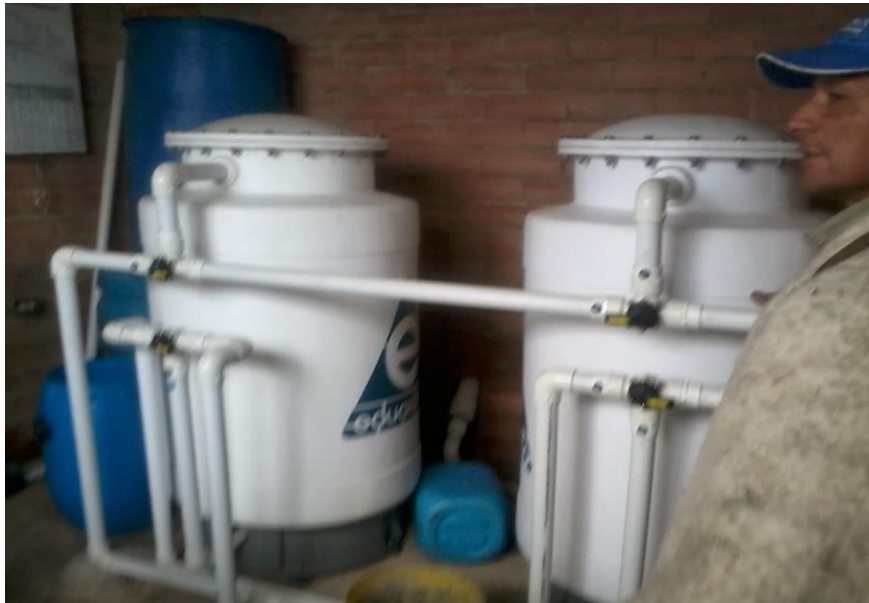
Ilustración 5: Planta de tratamiento Acueducto Los Soches
