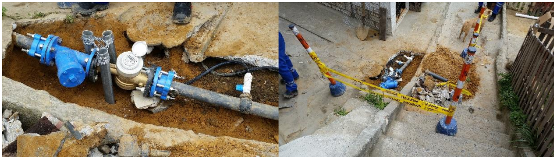
Figura 9. Instalación de medidor para zonas de usos irregulares en el sector del Águila en el barrio El Nevado de la ciudad de Manizales (Elaboración propia, 2016)
