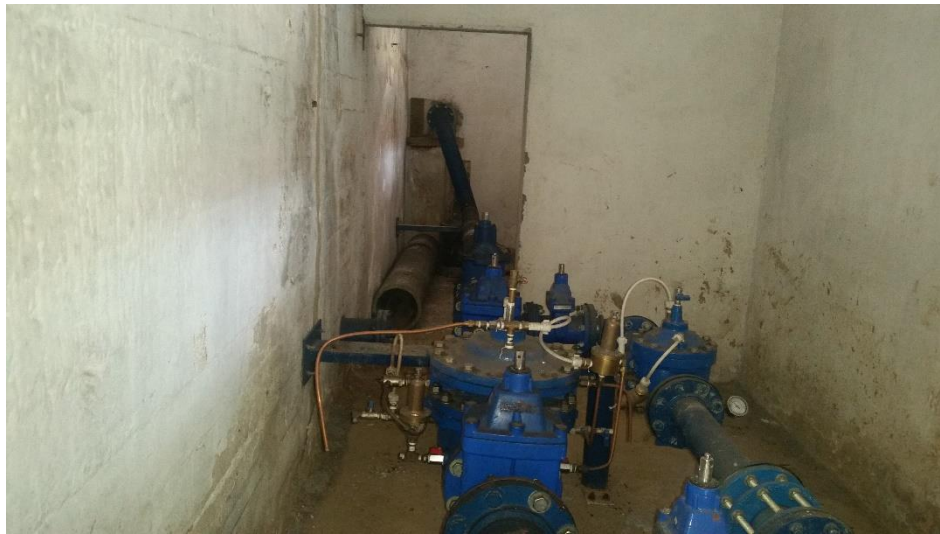
Figura 12. Estación reguladora ubicada en el tanque bellas artes (Elaboración propia, 2016)
