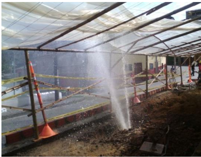
Figura 3. Daño de tubería de acueducto (LA PATRIA, 2014)
