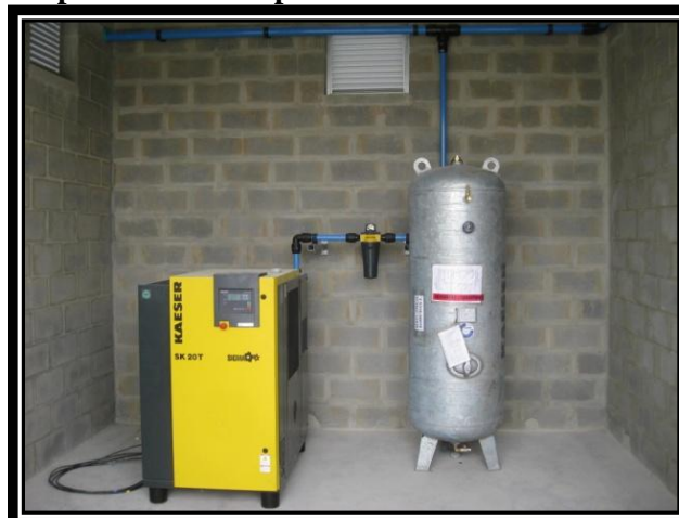
Figura 17: Compresor 88 CFM para Generación de Aire Comprimido (35)
