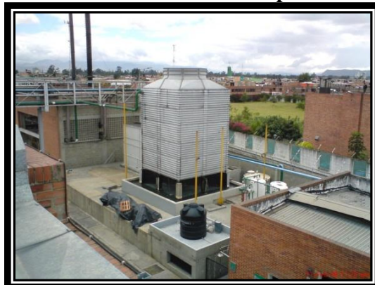
Figura 16: Torre de enfriamiento en planta de Lácteos
