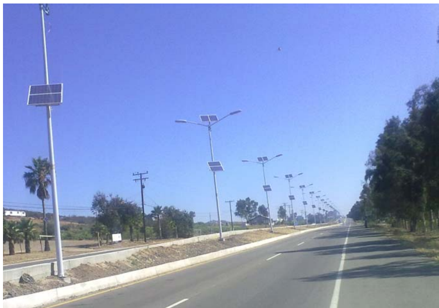
Fig. 25: Módulos fotovoltaicos suministran energía eléctrica para alumbrar la vía en San Antonio, Baja California, México.
