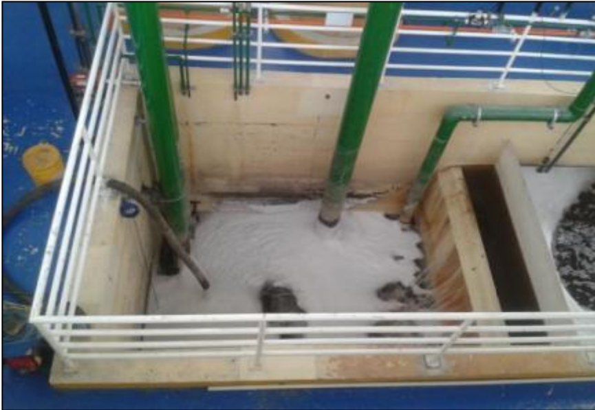
Foto 3-1: Estación de Bombeo de aguas residuales crudas
