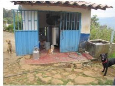
Tanque de frío
