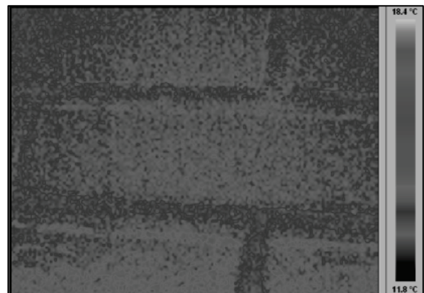
Figura 8. Termografía exterior de la fachada, vivienda D Fuente: Los autores
