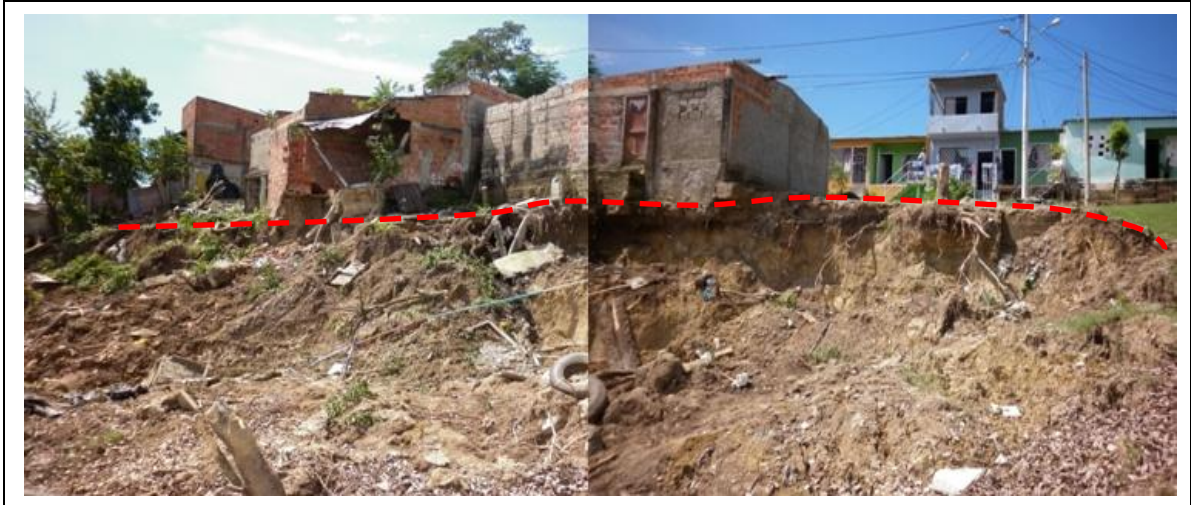
Figura 139. Escarpe principal y corona del deslizamiento de Manzanares
