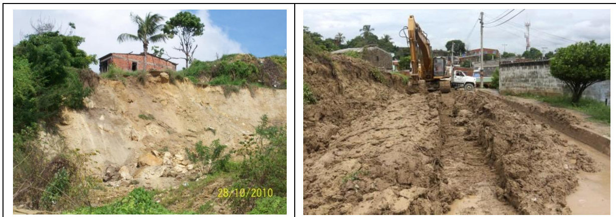
Figura 138. Escarpe principal y flujo de material por efecto de las lluvias - Nueva Granada
