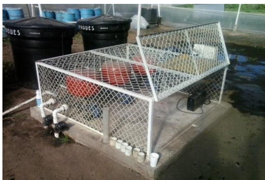
Figura 3-7: Bomba que impulsa el agua del tanque de reserva.
