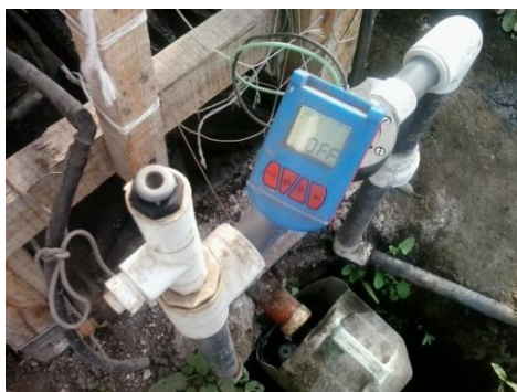
Figura 3-8: Controlador de riego
