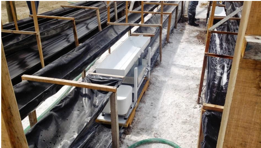
Figura 2-13: Instalación del Lisímetro de pesada “UNlisitrón” en las camas donde se siembra clavel.
