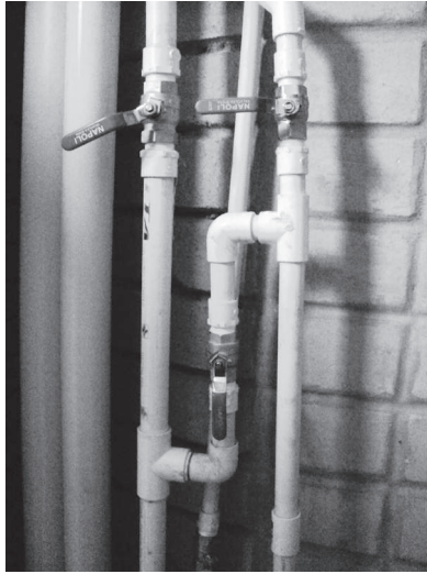
Fotografía 28. Tuberías internas de abastos: aguas lluvia y acueducto. (Fuente: Bedoya, C. 2014).
