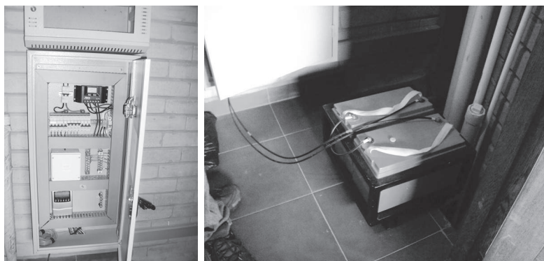
Fotografías 29 y 30. Gabinete técnico de control; convertidor de energía y baterías de almacenamiento.
