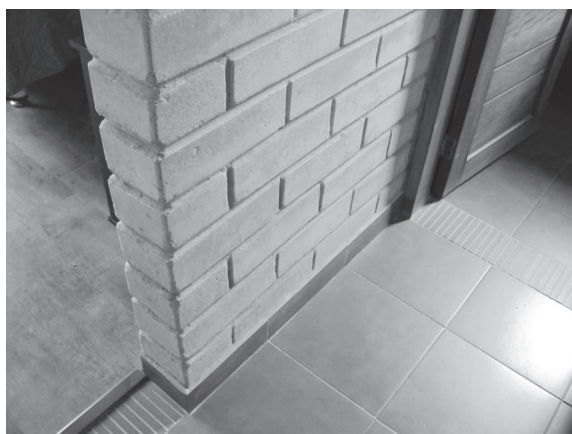
Fotografía 23. Detalle de pieza entera y medias piezas en muros; y en el piso las fajas cerámicas que propician la utilización de la baldosa completa, sin necesidad de corte. (Fuente: Bedoya, C. 2014).
