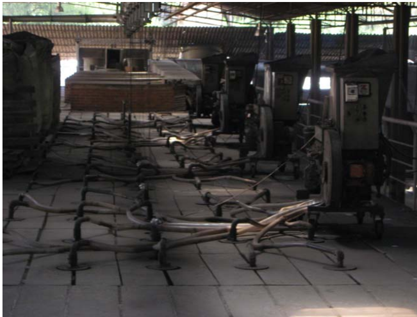
Figura 3. Horno túnel zona de cocción
